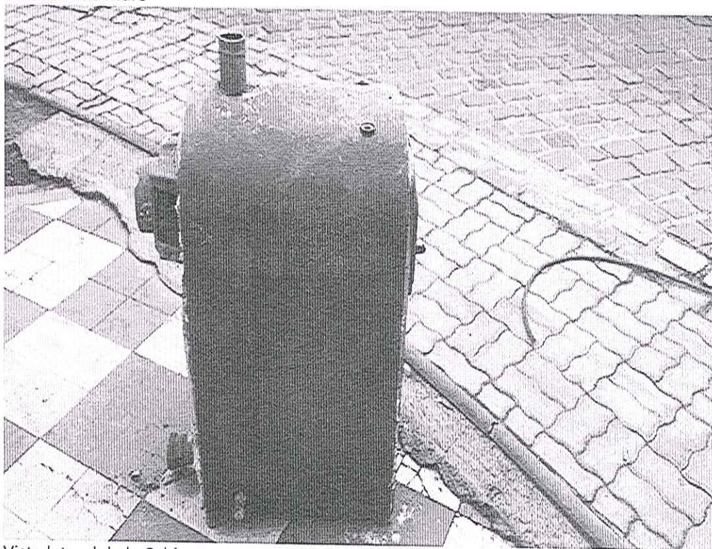
Vista lateral de la Caldera
