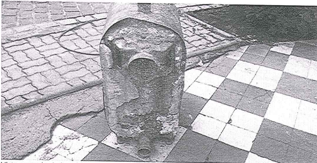
Vista costado de la caldera
