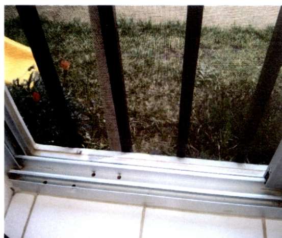
14. Malla mosquitera de ventana de baño de menores en mal estado Jardín "Carita de ángel"
