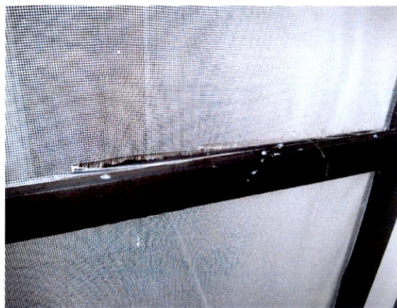
16. Malla mosquitera de puerta acceso patio de servicio se encuentra en mal estado Jardín "Siete colores"
