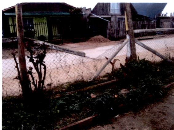
4. Cierre perimetral en mal estado Jardín "Santa Sofía"
