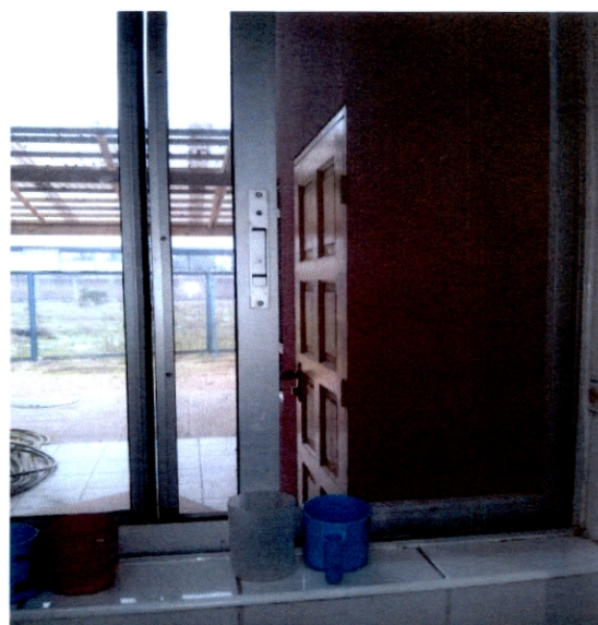
10. Malla de ventana de niveles medios en mal estado Jardín "Villa Francia"
