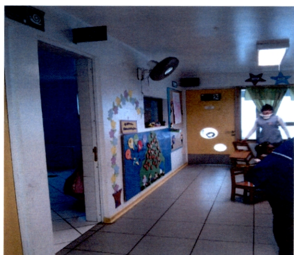
8. Ventilador anclado en la pared Jardín "Petetín"
