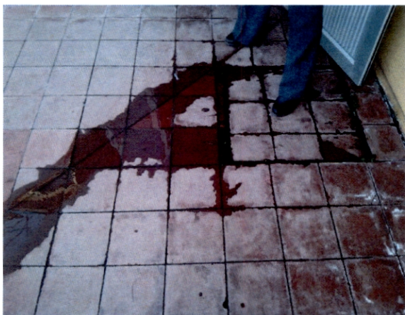
1. Filtración de desagüe en patio Jardín "Osito Pandy"
