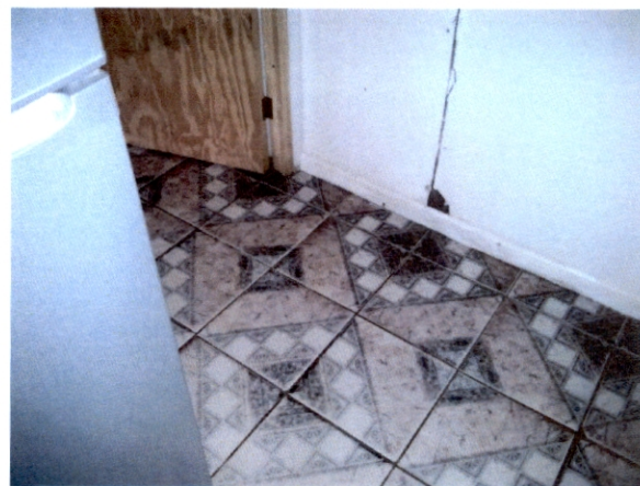
6. Perforación en pared de la bodega de alimentos, Jardín "Santa Sofía"
