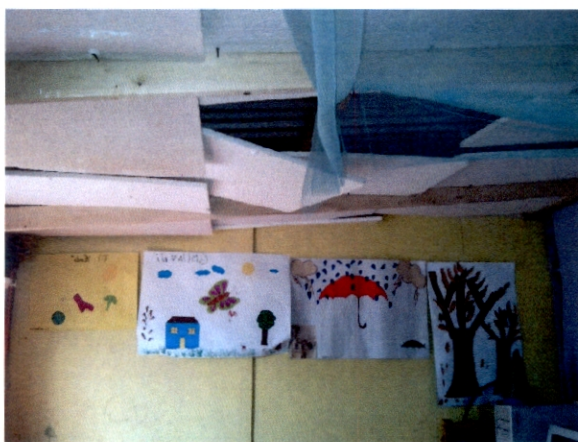
7. Cielo del establecimiento en mal estado, Jardín "Pelusita".
