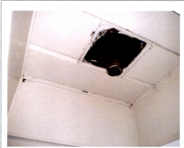
1. Extractor de campana sucio Jardín "Osito Pandy"
