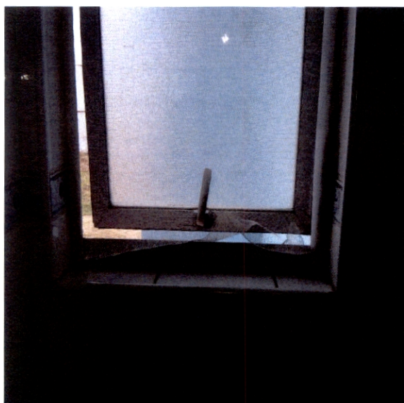
9. Malla de ventana de baño de personal en mal estado Jardín "Villa Francia"
