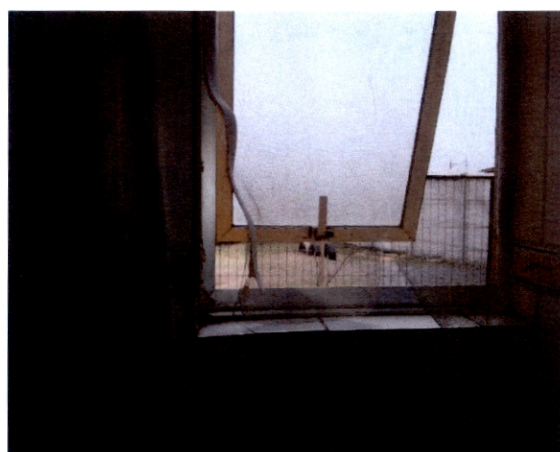
8. Malla de ventana de baño de manipuladoras en mal estado Jardín "Villa Francia"
