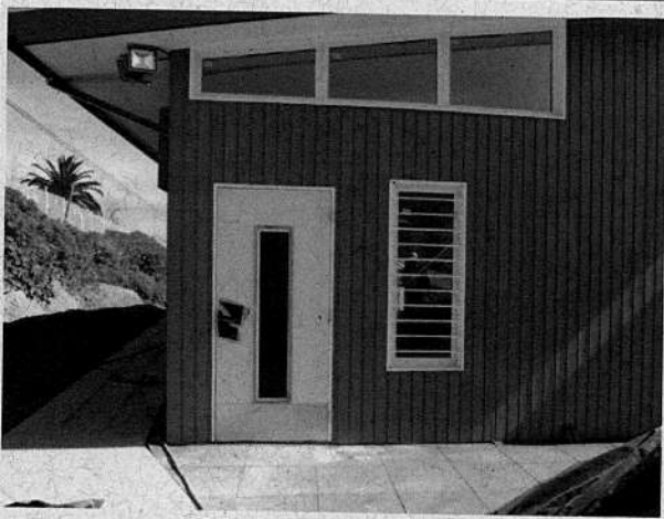
Fotografía N° 31, 11-08-16: Puertas no están revestidas con el material laminado tipo Lamitech.
