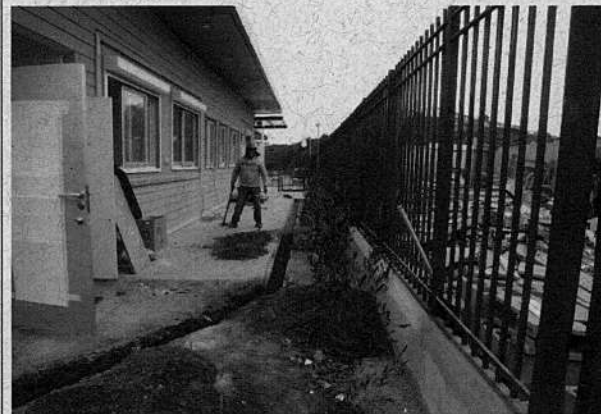
Fotografía N° 5, 24-08-16: F 5.0, Evacuación de aguas lluvias, San Columbano, Valparaíso.
