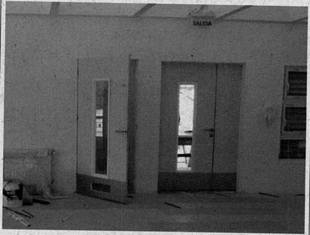
Fotografía N° 32, 11-08-16: Puertas no están revestidas con el material laminado tipo Lamitech.
