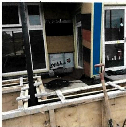
Fotografía N° 5, ausencia de algunas planchas Fibrocemento, fachada poniente.
