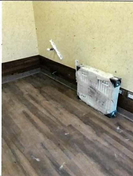
Fotografía N° 15 y 16, instalación de clima sin terminar
