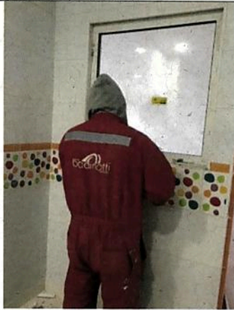
Fotografía N° 3 : En visita a terreno se constató a trabajadores sin la correcta implementación de seguridad personal
