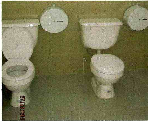
Fotografía N° 39 – 27/7/2016 WC párvulos instalados no cumplen con lo especificado, obra La Arboleda.
