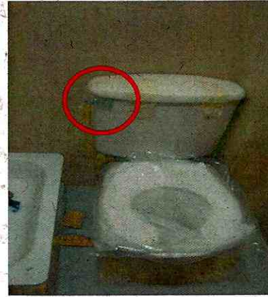
Fotografía N° 40 – 22/7/2016 WC párvulos instalados no cumplen con lo especificado, obra 18 de Septiembre.
