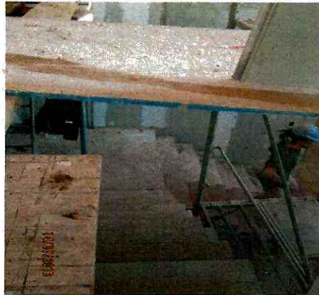
Fotografía N° 3 – 14/7/2016 Ancho de huella escalera obra Neftalí Galleguillos no se ajusta a OGUC.
