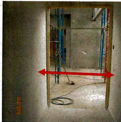
Fotografía N° 14 – 13/7/2016 Circulación área de servicios no cumple con el ancho mínimo exigido en la OGUC, obra 18 de Septiembre.
