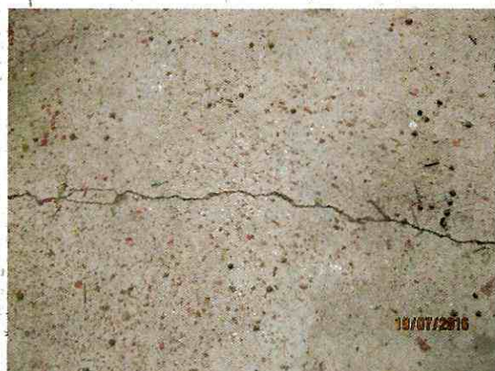
Fotografía N° 30 – 19/7/2016 Fisuras en radier ejecutado patio exterior obra Antakari.
