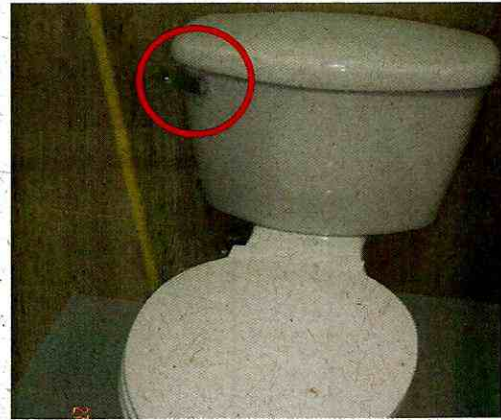
Fotografía N° 38 – 27/7/2016 WC adulto instalado no cumplen con lo especificado, obra La Arboleda.
