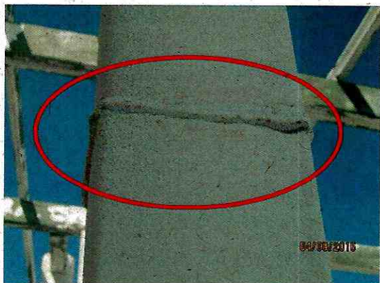
Fotografía N° 48 – 4/8/2016 Pilares metálicos P1, no se ajustan a lo especificado, obra La Pampilla.
