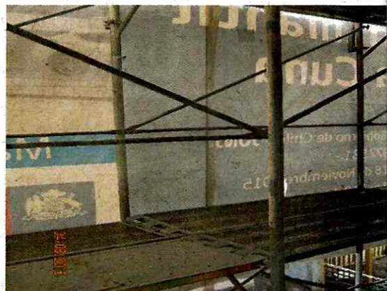
Fotografía N° 26 – 4/8/2016: Andamios no se ajustan a normativa, obra La Pampa.
