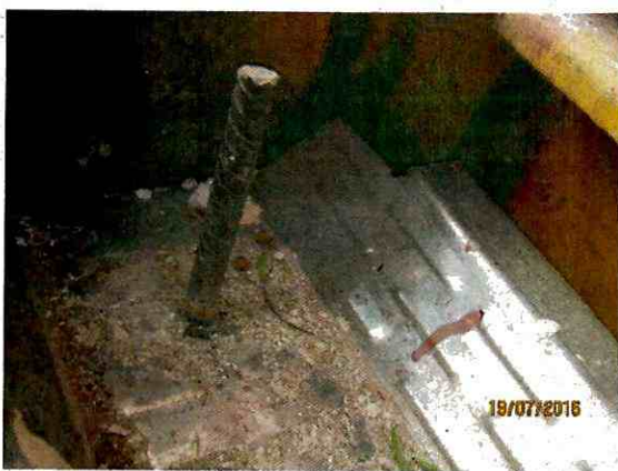
Fotografía N° 17 – 19/7/2016 Uso de barras estriadas de acero en vez de pernos de corte Nelson Stud especificado, obra Antakari.
