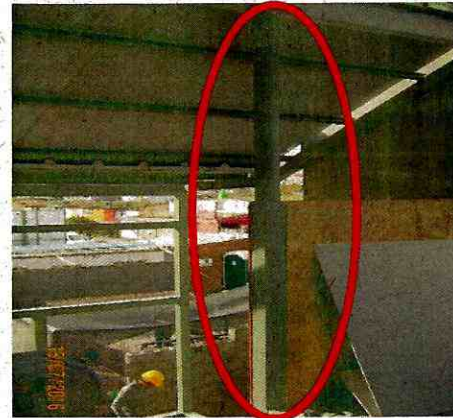
Fotografía N° 42 – 13/7/2016 Elemento metálico instalado no se ajusta con el proyecto de estructuras, obra 18 de Septiembre.
