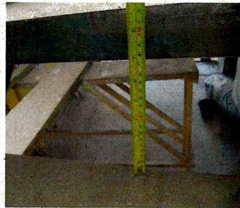
Fotografía N° 2 – 8/7/2016 Escalera con alturas de contrahuella no se ajusta a OGUC, obra La Cantera.
