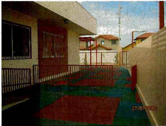
Fotografía N° 37 – 27/7/2016 Presencia de humedad piso de caucho multicolor, obra La Arboleda..
