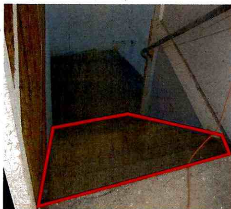
Fotografía N° 5 – 3/8/2016 Omisión de un peldaño en segundo tramo escalera obra La Pampilla.
