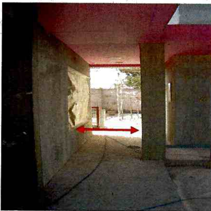
Fotografía N° 15 – 3/8/2016 Circulación exterior techada no cumple con ancho mínimo señalado en OGUC, obra Neftalí Galleguillos.
