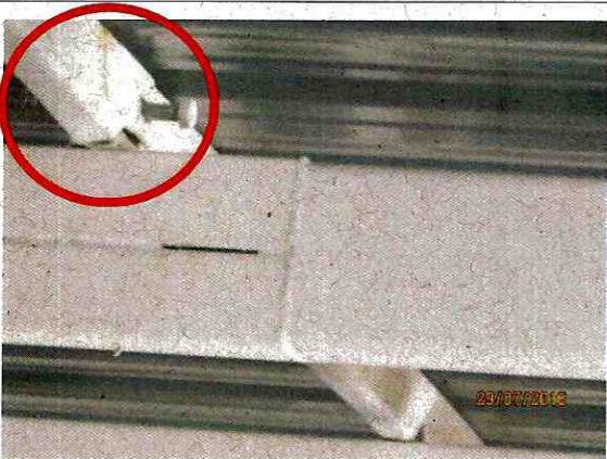
Fotografía N° 47 – 29/7/2016 Deficiencias en fijación costanera metálica a viga, estructura de techumbre, obra La Pampa.
