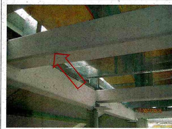
Fotografía N° 43 – 13/7/2016 Viga metálica instalada no se ajusta a lo especificado, obra 18 de Septiembre.
