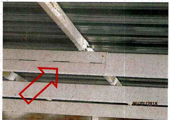
Fotografía N° 46 – 29/7/2016 Viga metálica instalada estructura de techumbre no se ajusta a lo especificado, obra La Pampa.
