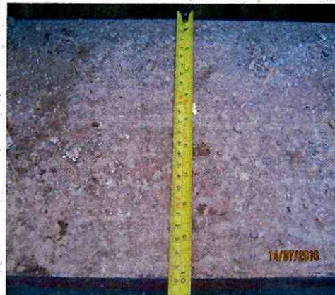
Fotografía N° 4 – 14/7/2016 Ancho de huella escalera obra Neftalí Galleguillos no se ajusta a OGUC.
