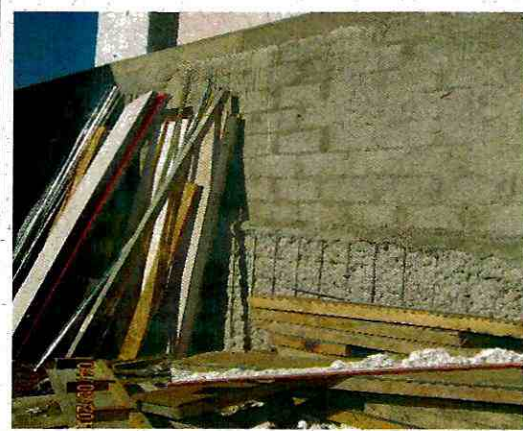
Fotografía N°55 – 4/8/2016 Muro contención, área hormigón armado con deficiencias, obra La Pampa.
