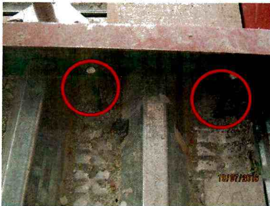
Fotografía N° 16 – 19/7/2016 Conexión placa colaborante con estructura metálica no se ajusta a lo especificado, obra Antakari.
