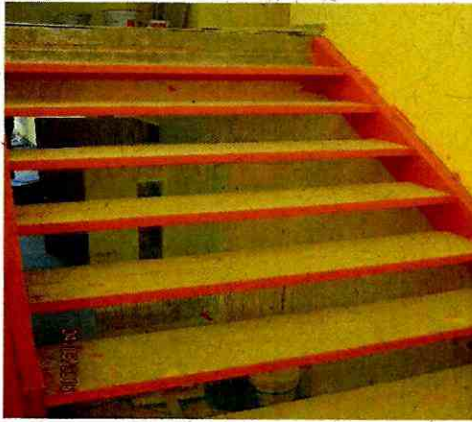
Fotografía N° 1 – 4/8/2016: Omisión de ejecución de un peldaño en escalera obra La Cantera.
