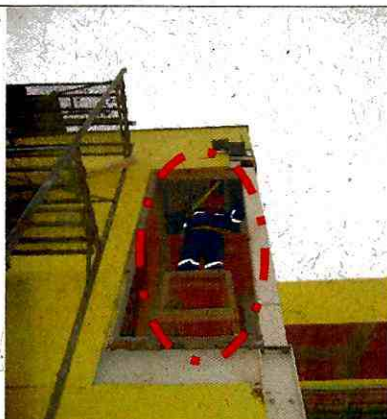
Fotografía N° 27 – 22/6/2016: Personal efectuando trabajos en altura sin arnés, cuerda de vida y casco de seguridad, La Cantera.
