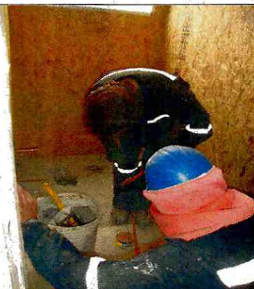
Fotografía N° 28 – 22/6/2016: Personal efectuando soldadura sin casco de seguridad y sin máscara de protección, La Cantera.
