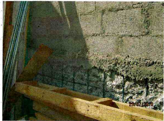
Fotografía N° 56 – 29/7/2016 Muro contención, área hormigón armado con deficiencias, obra La Pampa.
