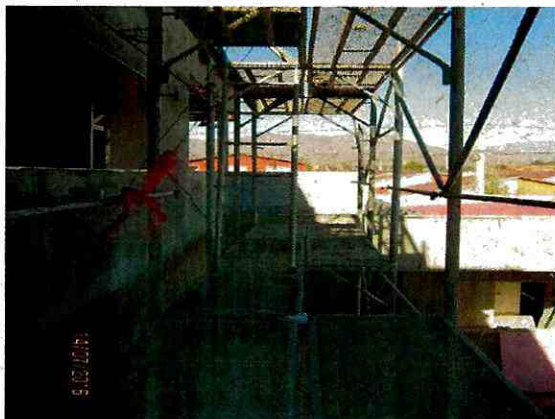
Fotografía N° 25 – 14/7/2016: Andamios no se ajustan a normativa, obra Neftalí Galleguillos.
