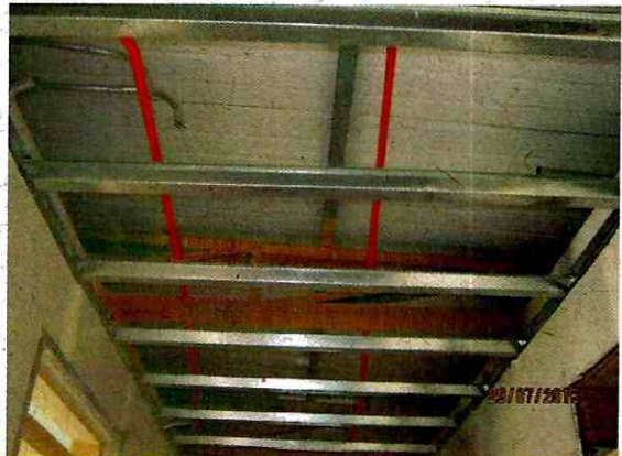
Fotografía N° 4 – 29/7/2016: Cerchas metálicas sin pintura intumescente, obra La Pampa
