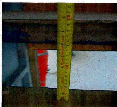
Fotografía N° 6 – 3/8/2016 Altura de contrahuella no se ajusta a lo señalado en OGUC.
