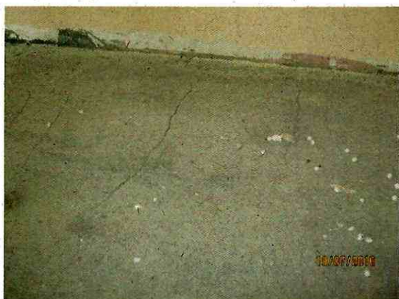
Fotografía N° 29 – 19/7/2016 Fisuras en radier ejecutado bodega primer nivel obra Antakari.
