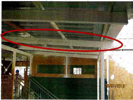
Fotografía N° 45 – 29/7/2016 Viga metálica instalada estructura de techumbre no se ajusta a lo especificado, obra La Pampa.
