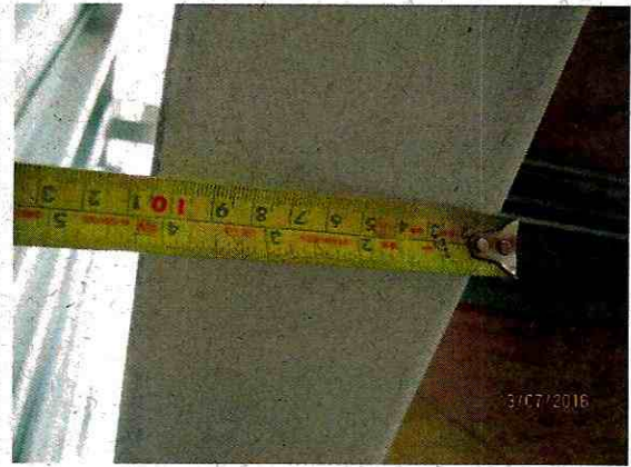
Fotografía N° 44 – 13/7/2016 Viga metálica instalada no se ajusta a lo especificado, obra 18 de Septiembre
