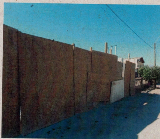
Fotografía N° 33: Cierre provisorio no pintado, JI Rahue.
