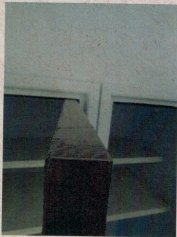
Fotografía N° 26: Falta de pintura en cantos de puertas, JI Rahue.
