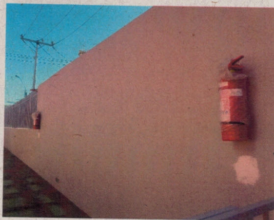
Fotografía N° 31: Extintores expuestos a la intemperie, JI Rahue.
