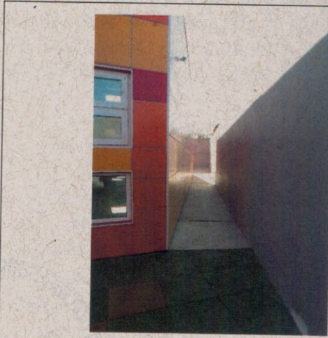
Fotografía N° 1: Menor distanciamiento que el exigido en normativo, JI Rahue.
