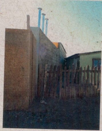
Fotografía N° 37: Falta de estuco en muro medianero, JI Rahue.
