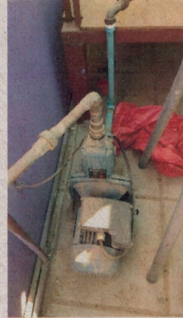
Fotografía N° 49: Falta de funcionamiento de bomba hidropack, JI Incahuara.
