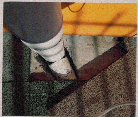
Fotografía N° 29: Bajadas de aguas lluvias de PVC, JI Rahue.
