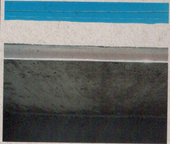
Fotografía N° 27: Falta de pintura en nichos, JI Rahue.
