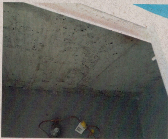
Fotografía N° 28: Falta de pintura en nichos, JI Rahue.
