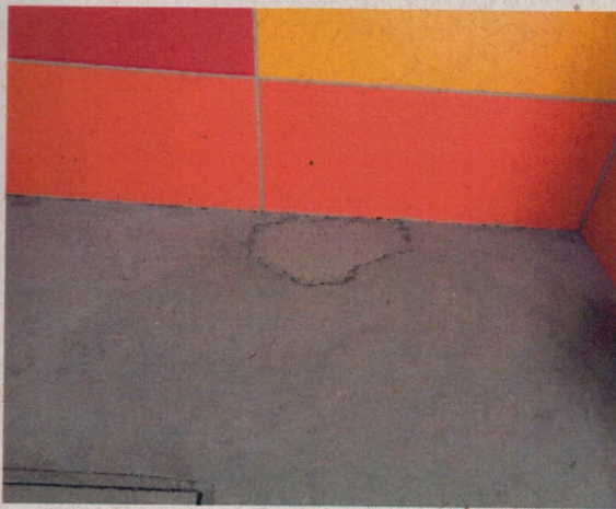
Fotografía N° 46: Poca prolijidad en terminaciones, parche de hormigón, JI Rahue.
