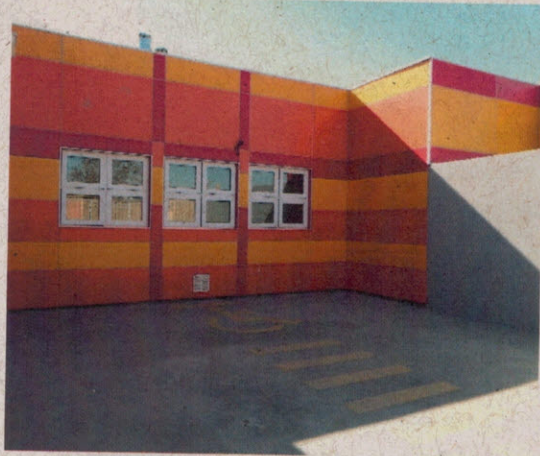
Fotografía N° 4: Falta de proyecto de pavimentación, JI Rahue.
