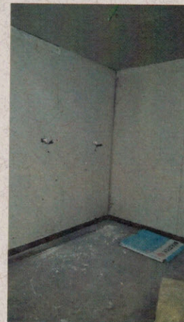
Fotografía N° 47: Poca prolijidad en terminaciones, falta de protección de pavimento instalado, JI Pecezuelos.
