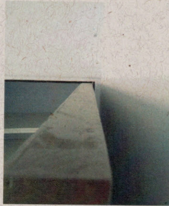
Fotografía N° 45: Poca prolijidad en terminaciones, falta de pintura en cantos de puertas, JI Rahue.
