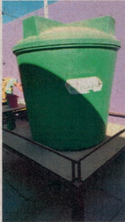
Fotografía N° 48: Falta de funcionamiento de bomba hidropack, JI Incahuara.
