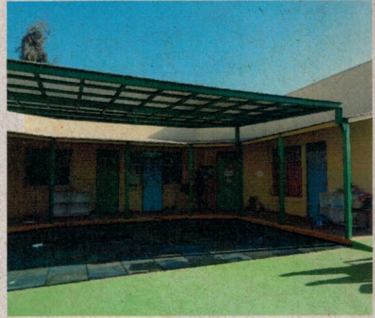
Fotografía N° 51: Filtración en sombreadero instalado, JI Semillitas de San Alberto.
