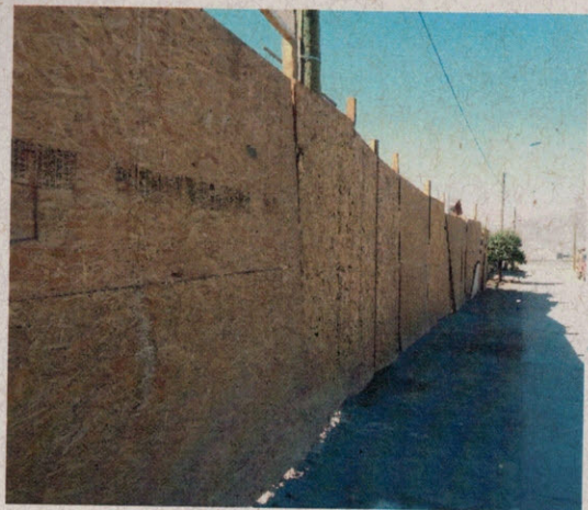
Fotografía N° 34: Cierre provisorio no pintado, JI Rahue.
