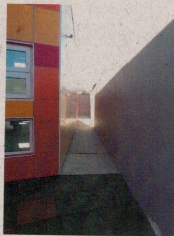
Fotografía N° 35: Falta de reja en vía de evacuación, JI Rahue.
