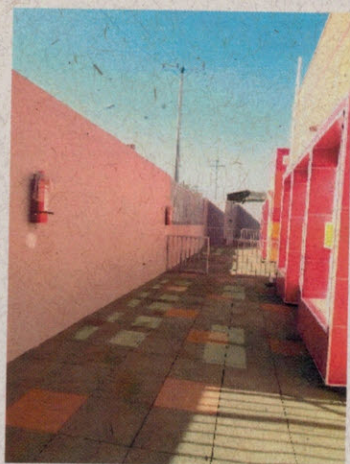
Fotografía N° 32: Extintores expuestos a la intemperie, JI Rahue.
