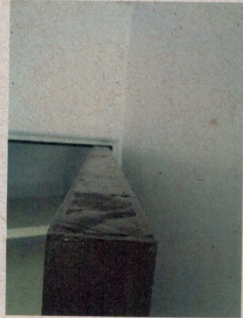
Fotografía N° 25: Falta de pintura en cantos de puertas, JI Rahue.
