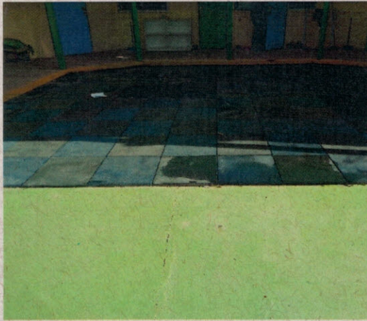
Fotografía N° 50: Filtración en sombreadero instalado, JI Semillitas de San Alberto.
