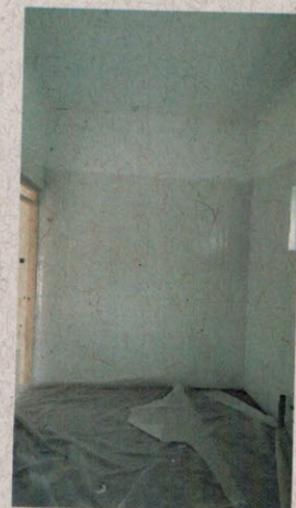
Fotografía N° 41: Cerámica de muro incompleta, JI Pecezuelos.
