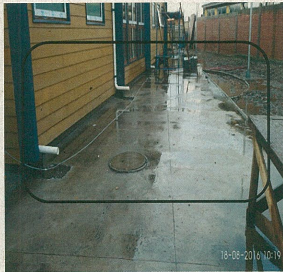
Fotografía N° 6: Sistema de evacuación de agua lluvias.
