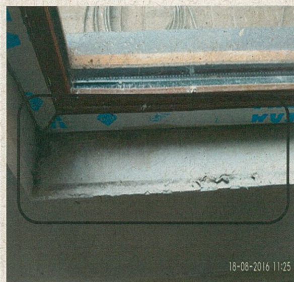
Fotografía N° 4: Vano de ventanas sin sobremarco de madera.
