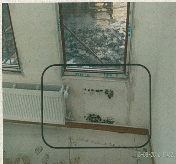
Fotografía N° 5: Humedad en muros.
