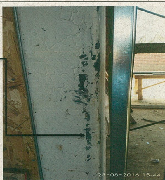
Fotografía N° 14 Vista pintura intumescente descascarada.
