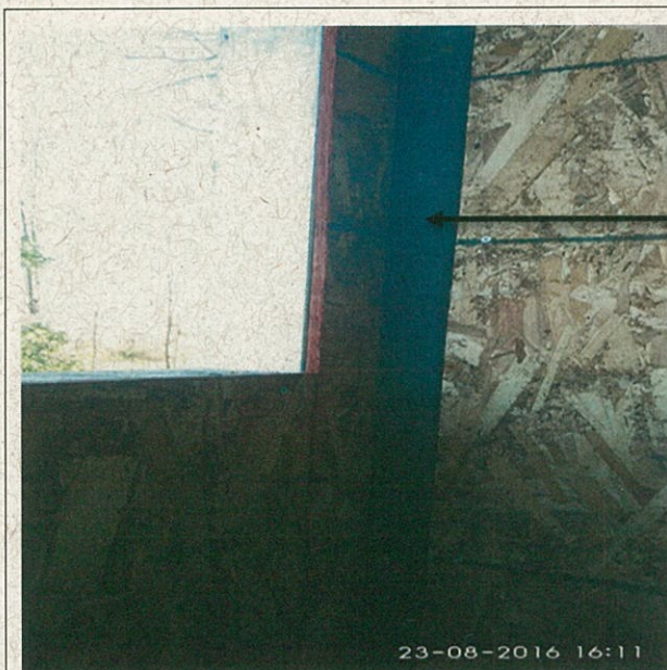
Fotografía N°13: Vista de estructura metaliza sin pintura intumescente.
