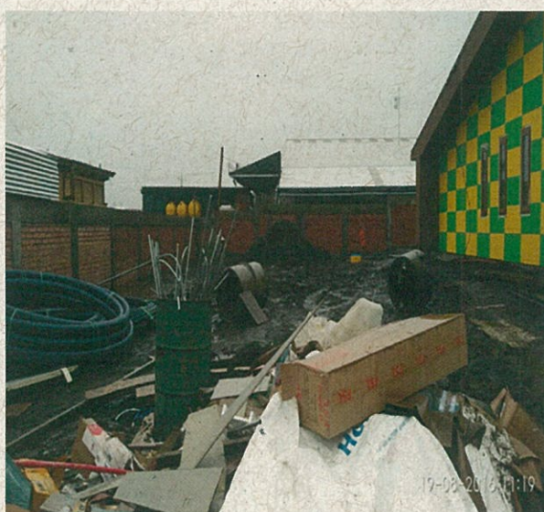
Fotografía N° 9: Vista de escombros no retirados.
