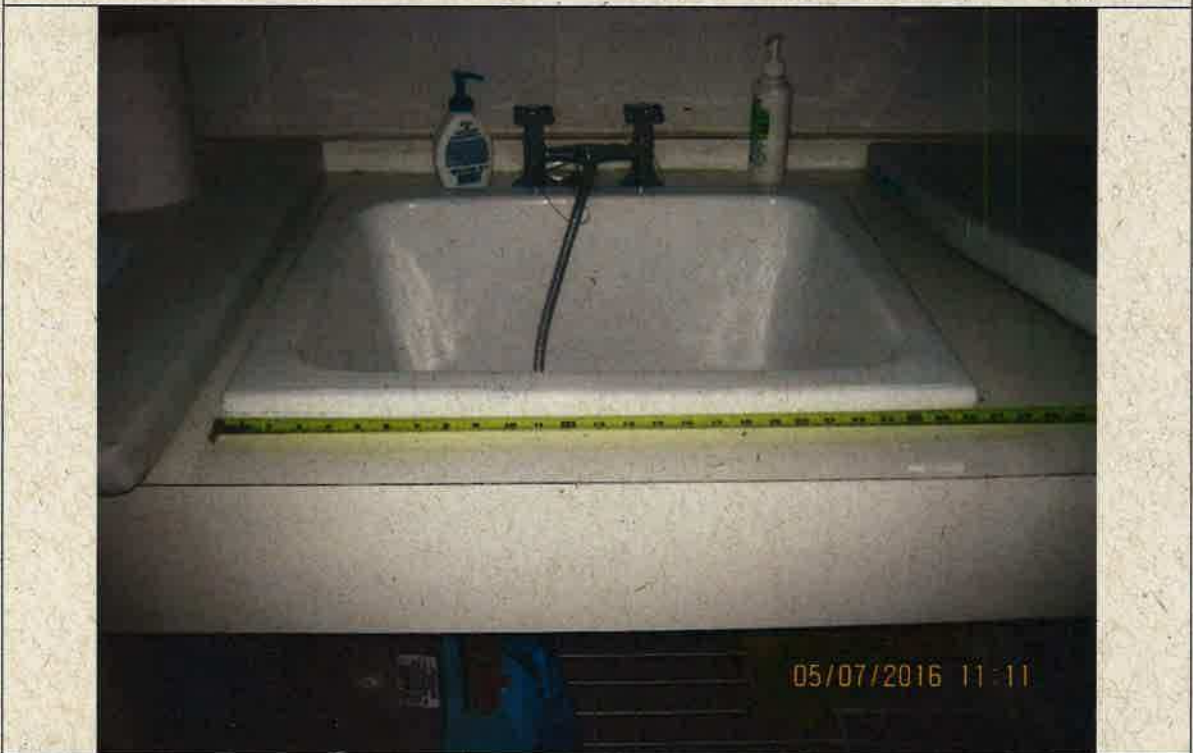
2) Baño Acero Esmaltado dispuesto de 70 x 70 centímetros, a diferencia de lo requerido en 105 x 70 centímetros.
