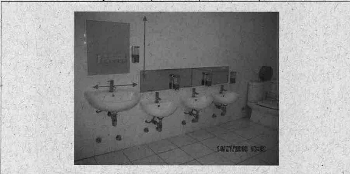
1) Sala de hábitos higiénicos; Espejo. dimensión ejecutada; 0.6 x 0.5 (centímetros). Dimensión especificada; 0.6 x 0.8 (centímetros).
