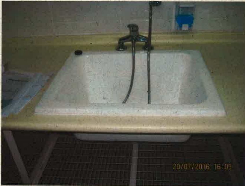
3) Bañera Acero Esmaltado, dimensión ejecutada 56 x 70 (centímetros). Dimensión especificada; 105 x 70 (centímetros).
