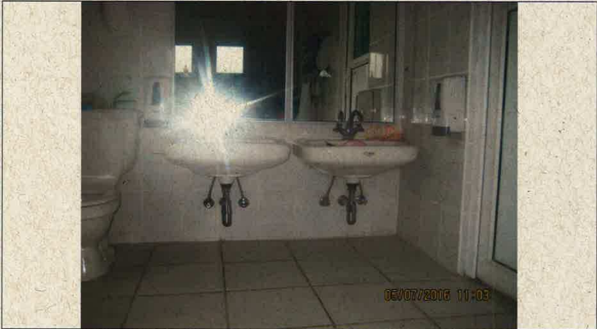
1) Lavamanos párvulos sala de mudas sin pedestal.
