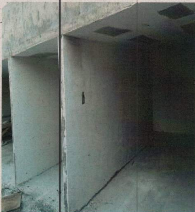
Foto 3: Diseño y Ejecución Sala Cuna y Jardín Infantil Nicolás Tirado, ejecución de trabajos sin autorización de la JUNJI, empaste de muros.
