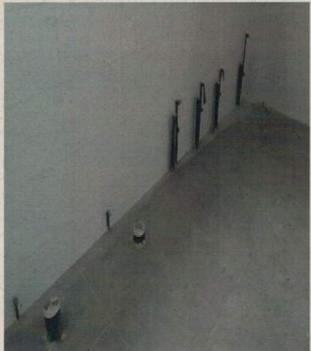
Foto 8: Diseño y Ejecución Sala Cuna y Jardín Infantil Chungungos, partida pagada no ejecutada, artefactos sanitarios, WC y lavamanos en SHHNM 01 y 02.
