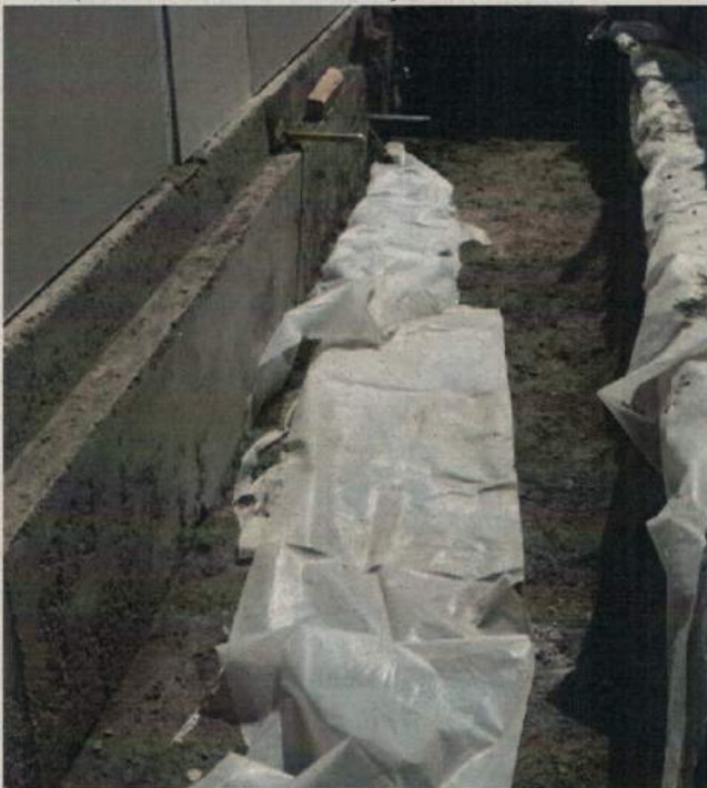
Foto 7: Diseño y Ejecución Sala Cuna y Jardín Infantil El Teniente, partida pagada no ejecutada, impermeabilización de fundaciones.
