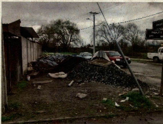
Fotografía N° 3: Uso de espacios públicos como acopio de escombros y materiales. Construcción Jardín Infantil Don Ignacio, Rauco.
