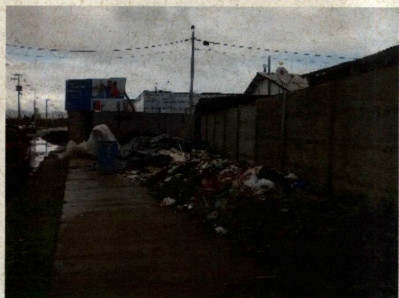
Fotografía N° 4: Uso de espacios públicos como acopio de materiales y escombros. Construcción Jardín Infantil Don Ignacio, Rauco.
