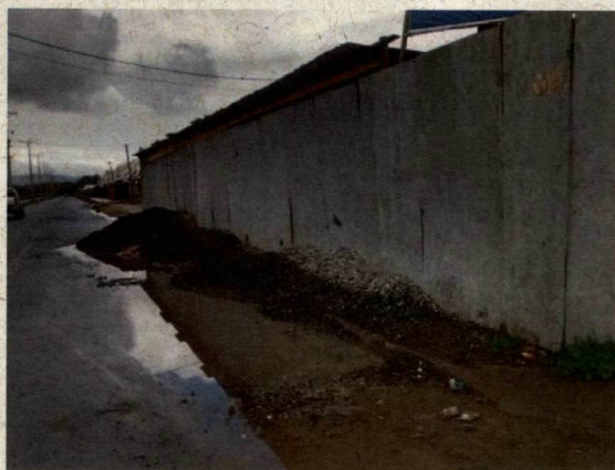
Fotografía N° 5: Detalle de emplazamiento de instalación de faenas y cierre perimetral de la obra, sobre bien nacional de uso público. Obra: Construcción Jardín Infantil Don Ignacio, Rauco.
